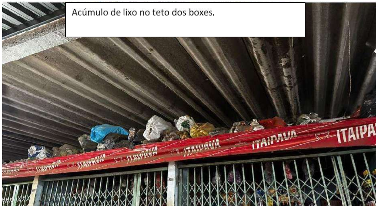
Visível depredação do bem público. Estado de abandono. 08/01/2025
