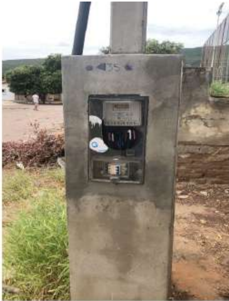
Foto 153 - Padrão de energia quadra das Baraúnas
