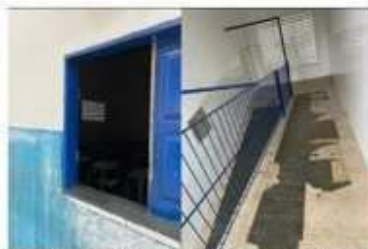
Janela quebrada e acesso ao 1º andar.
