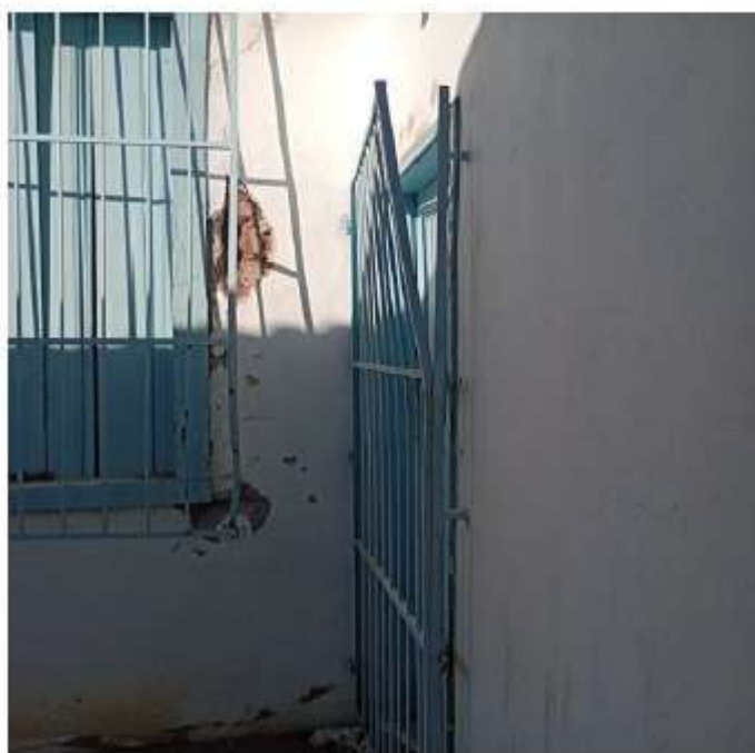
Foto 75 – Porta e janela do Arquivo Público arrombada
