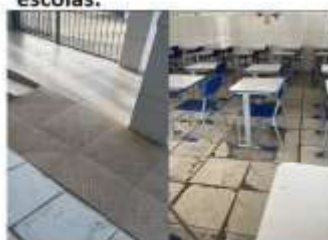
Rampa onde acontece quedas e piso de sala.
