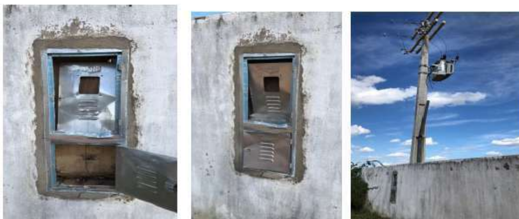
Fotos 03, 04 e 05 – Poste e Padrão de energia do Campo Clóvis José de Souza
