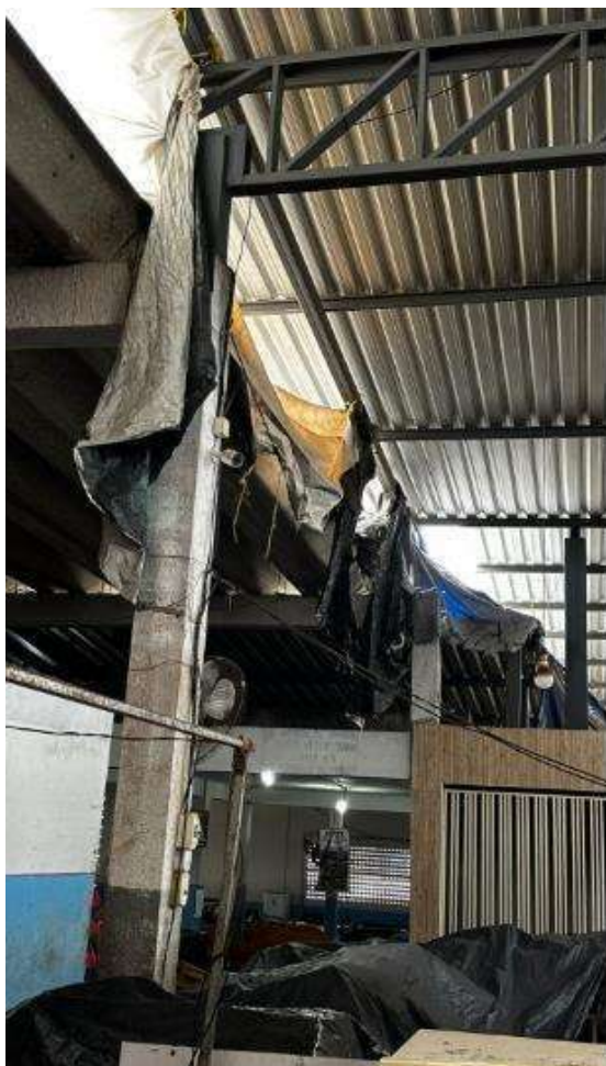
Comprometimento de cobertura de telhado 08/01/2025
