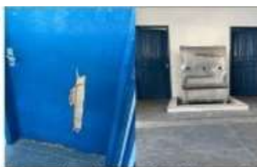
Porta do auditório, bebedouro e 2 banheiros inativos.
