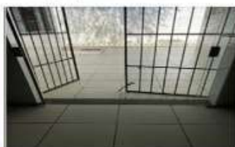
Porta da direção quebrada.
