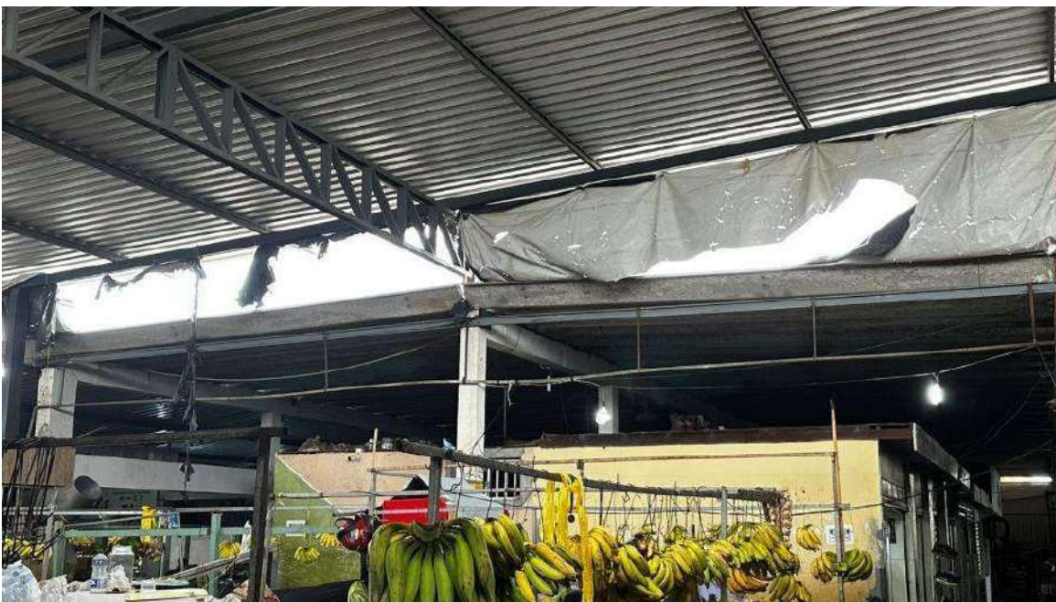
Comprometimento de cobertura de telhado
