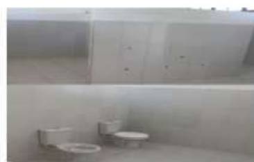
Banheiros da quadra, inaugurou mas não terminou.
