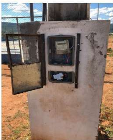
Foto 62 – Padrão de Energia danificada
